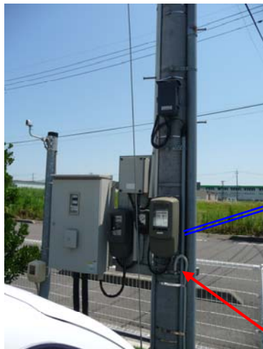
東北電力 引き込み柱
