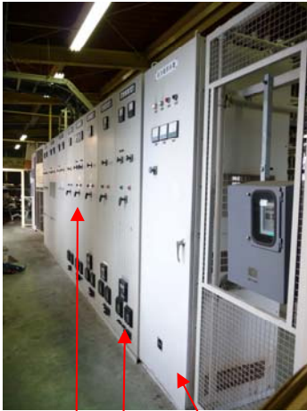
改修前 (OCB+OCR,DGR+直流電源盤)
