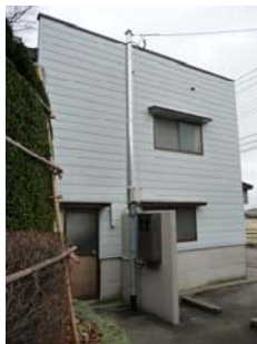
融雪用引込開閉器盤
