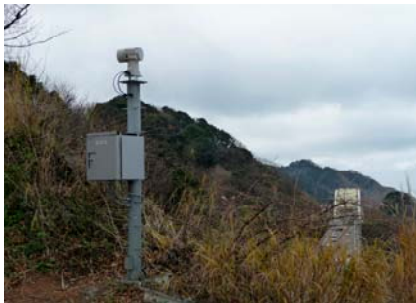
国道 8 号(柏崎)CCTV カメラ T 社製
