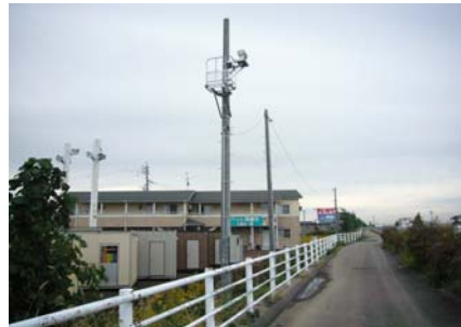
国道 8 号(長岡)CCTV カメラ T 社製
