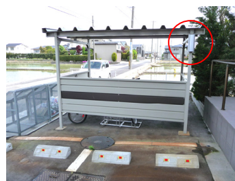
駐車場 LED 照明
