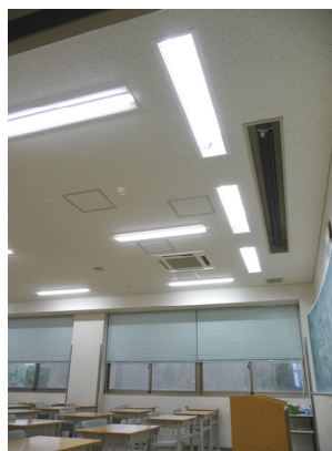
LED 照明(3800lm×3 台)
