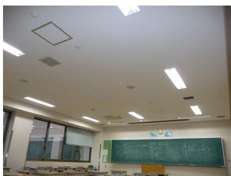
N 高専教室 蛍光灯(HF32W-2×9 台)
