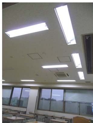
蛍光灯(HF32W×3 台)
