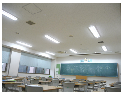
LED 照明(6710lm×9 台)
