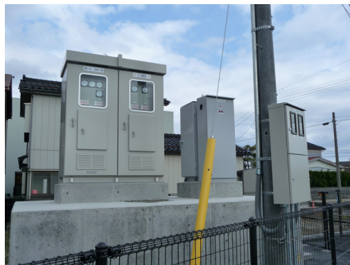
排水ポンプ制御盤
