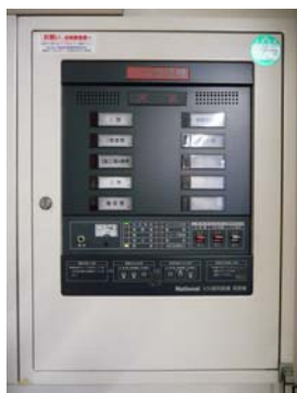
自動火災報知機 受信機
