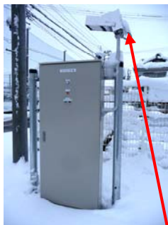
融雪制御盤と降雪センサー
