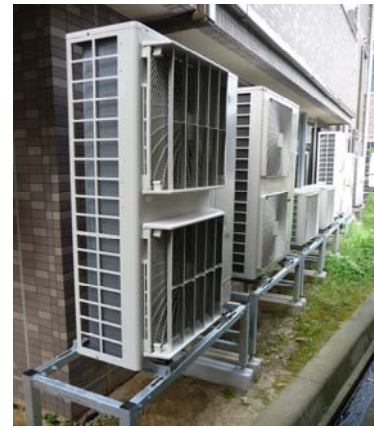
室外機 (吹出し方向をルーパで調整)
