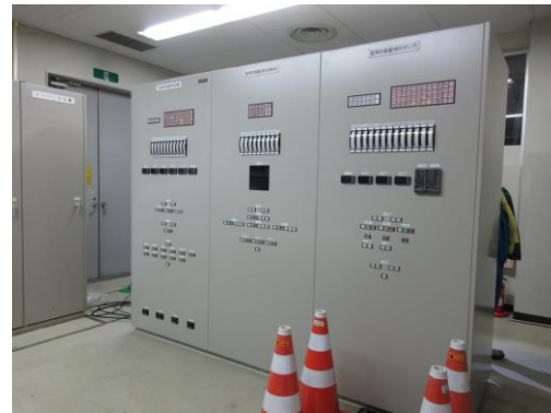
新設制御盤(制御室)
