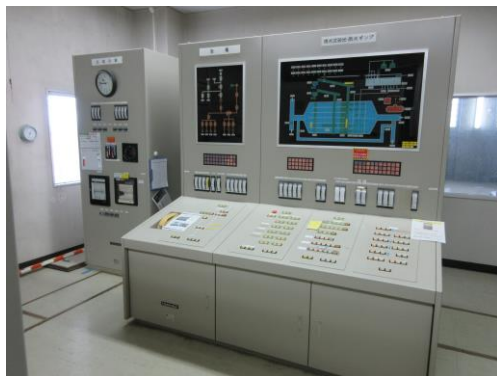
旧制御盤(制御室)
