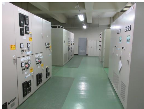
配線改修された受電盤と制御盤(電気室)
