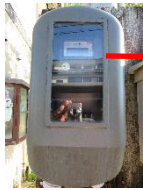
電力メーター
